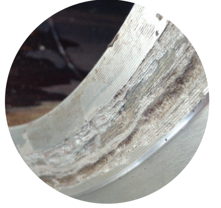
Geleneksel grafit contaların kullanımından kaynaklanan korozyon
